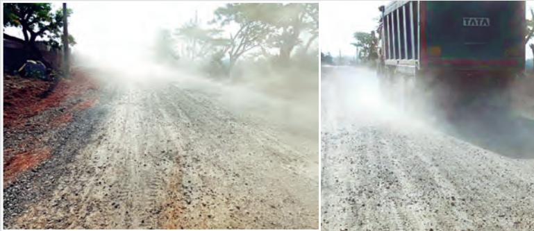
పనులు ఆగిపోవడంతో అసంపూర్ణంగా బీటీ రోడ్డు
